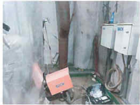
2#排气筒 DA002 (②) 有组织排放废气
